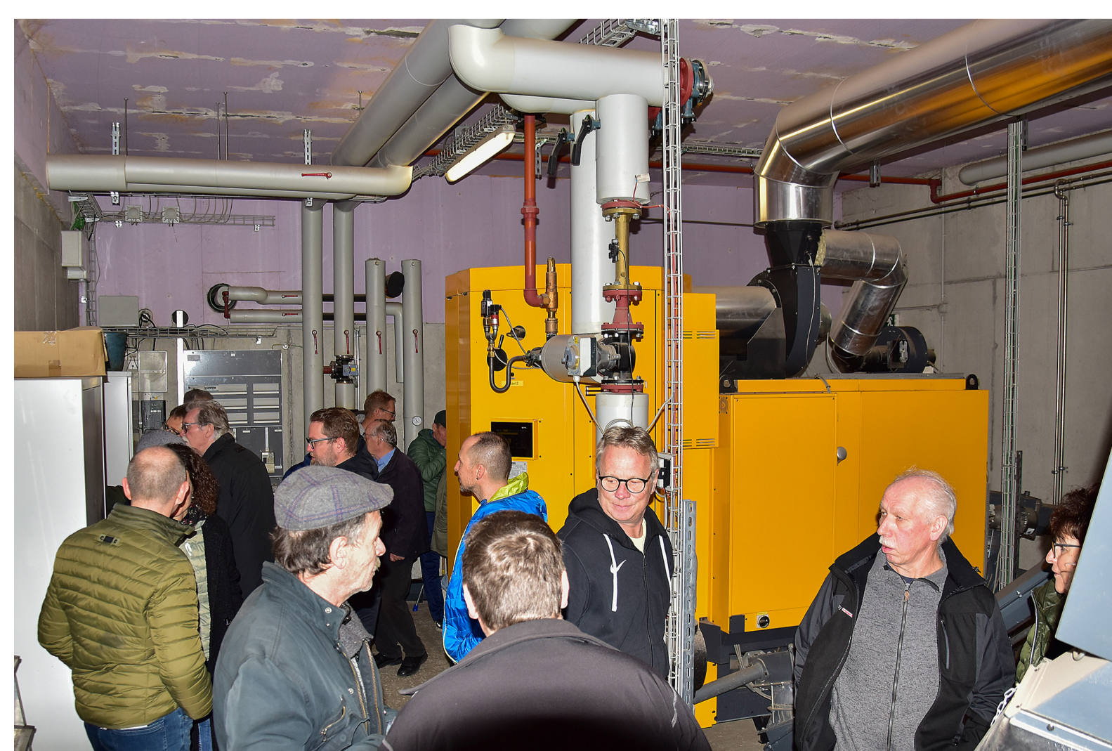
Im Heizkeller stehen zwei Öfen.
